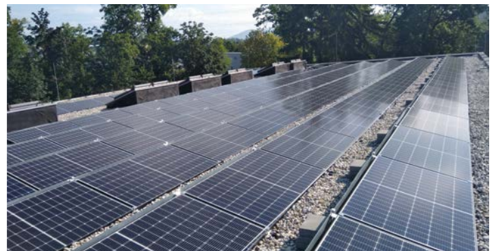
Eine der fünf neuen Photovoltaikanlagen befindet sich am Dach des Kindergarten Schulstraße.
